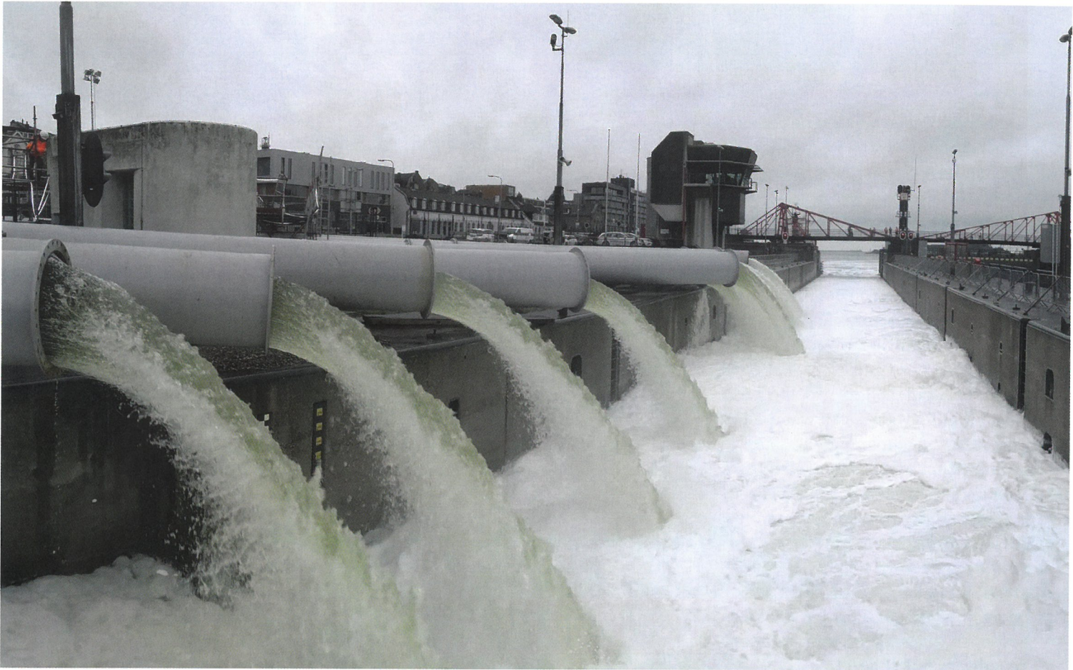
Bij een grote aanvoer vanuit het Noordzeekanaal loost een deel van de pompen in de kolk van de Kleine Sluis.
