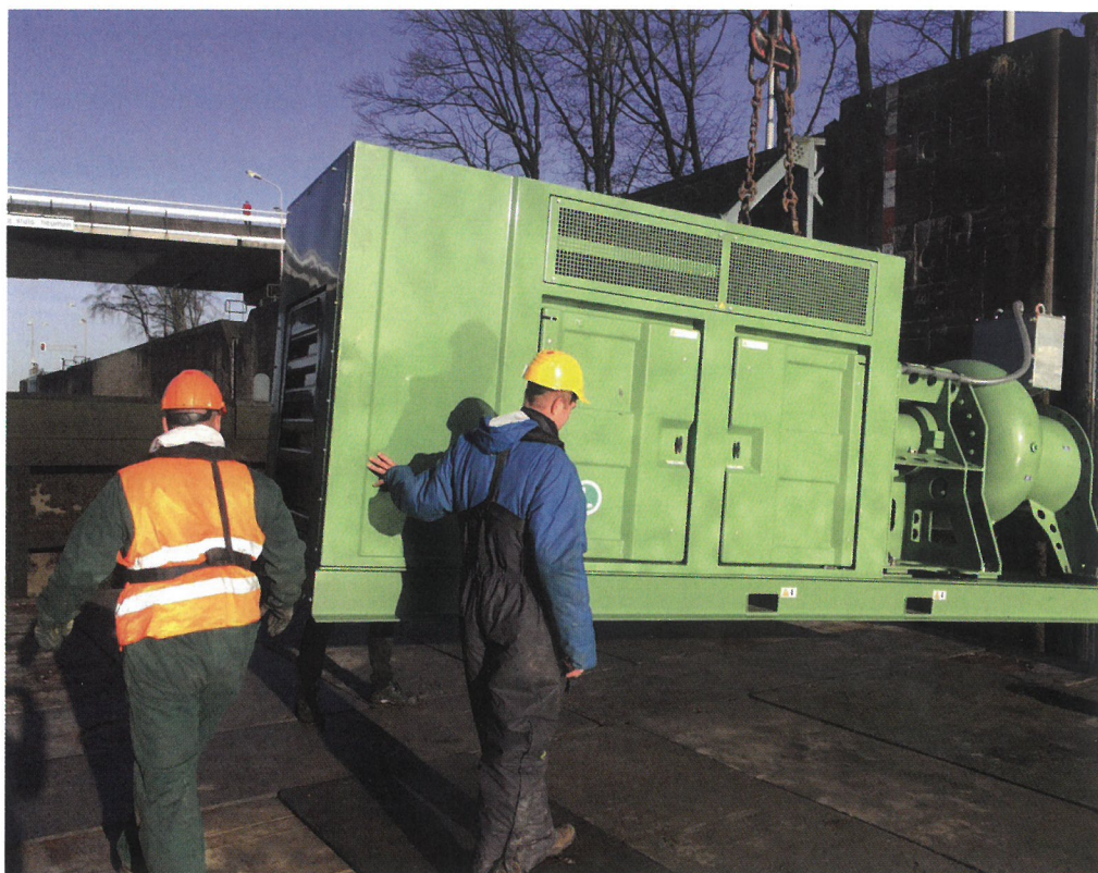
In 2017 plaatste Rijkswaterstaat noodpompen om het Maas-Waalkanaal op peil te houden.
